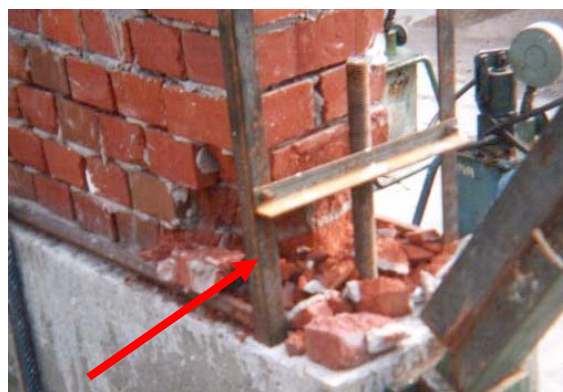
Foto 3.7 – Zdrobirea zidăriei în zona comprimată la P=20000daN
