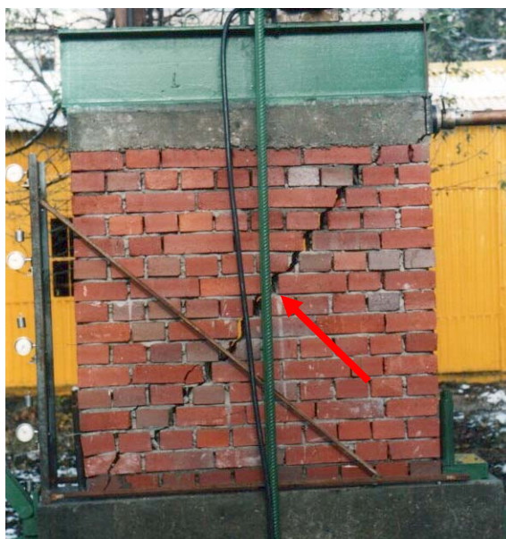
Foto 3.3 – Modul de rupere a elementului ES
